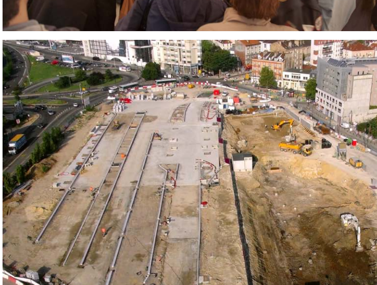
Vue sur le chantier de la Porte de Paris : création de voies, arrivée du tramway et emprise du programme Bouygues immobilier. Photo drone - © Plaine Commune Développement - septembre 2013.
